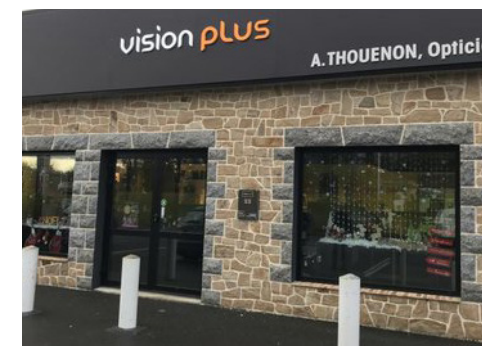
✗ Parements mur en moellons, chaînages et encadrements pierre factices peu qualitatifs
